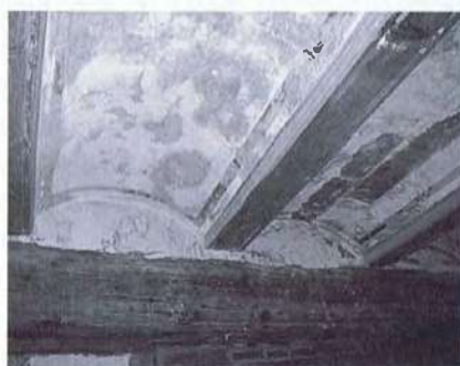
Fig. 4. Forjado de vigas de madera y revoltones con esgrafiados situado en la crujía trasera de la primera planta del edificio de viviendas situado en Calle Maldonado número 33 (siglo XVIII).
