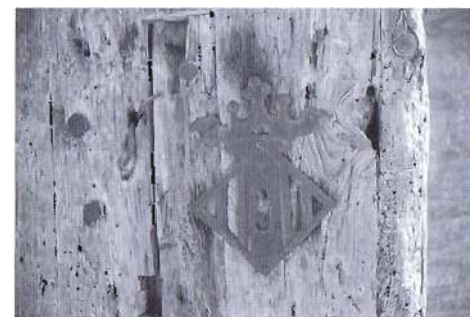
Elemento metallico di uno dei serramenti lignei prima dell'intervento di pulitura e conservazione.
