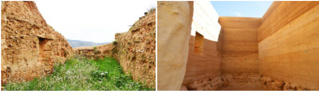
Fig. 1 Estado inicial y estado final del interior de la torre del Mediodía. Mainel intervención arquitectura SL (2021)
