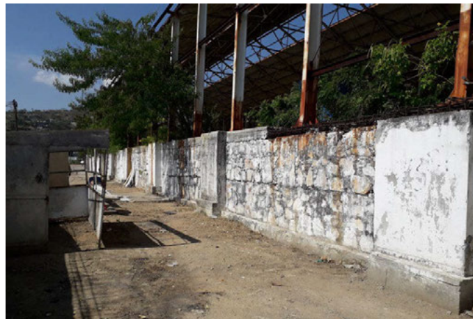
Fig. 6 Vista del muro de cimentación con grapas y cadena de arrastre de hormigón armado. Archivo de investigación del autor (2018)
