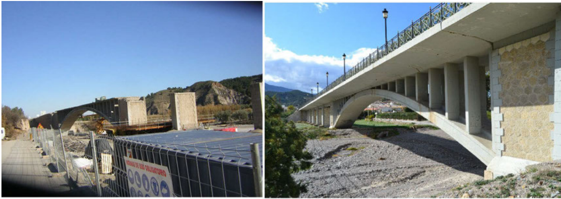
Fig. 6 Puente sobre el río Almanzora en Purchena(Almería). Izquierda, obras de restauración, en las que se sustituyó el tablero original por otro de nueva construcción más ancho. Derecha, estado actual
