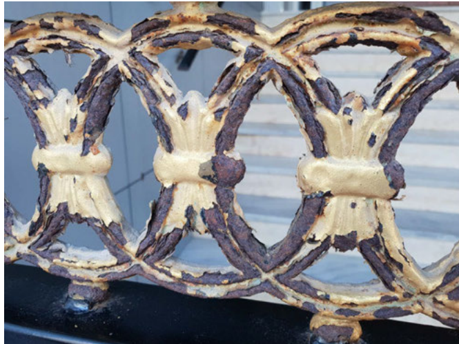
Fig. 1 Efecto de la oxidación en una reja de hierro en primera línea del mar. 2022
