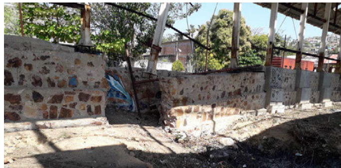
Fig. 8 Deslizamiento del muro de cimentación. Archivo de investigación del autor (2018)
