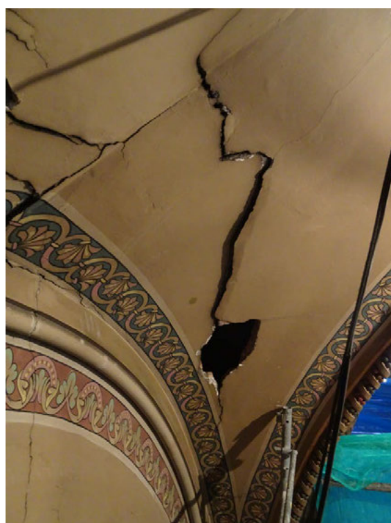
Fig. 4 Detalles de uno de los lunetos agrietados, con el agujero provocado por la caída de un trozo de bóveda (2020). ARAE Patrimonio y Restauración SLP
