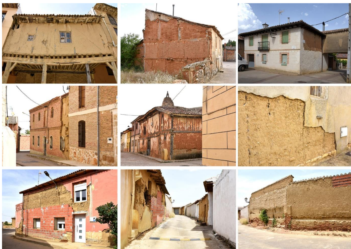
Figura 2. Algunos de los principales problemas de conservación detectados: (1,8,9) deformaciones y lesiones estructurales; (2,4,5,6,7,8,9) erosión; (2,4,8) pérdida de sección y de elementos; (1,5,6,7,8,9) pérdida de revestimiento; (3,4,5,6,7,8 y 9) introducción de materiales incompatibles
