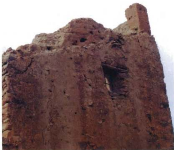
Sesga. Casa arruinada con restos de muro de tapial
