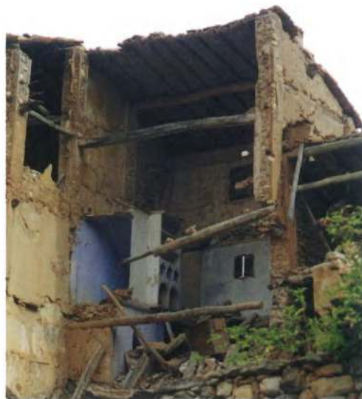
Sesga. Sección de una casa arruinada
