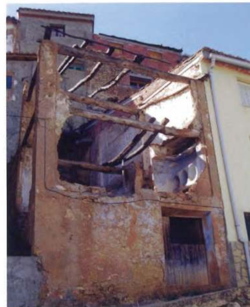
Castielfabib. Casa arruinada que desvela su estructura sustentante de machones de yeso y rollizos de madera
