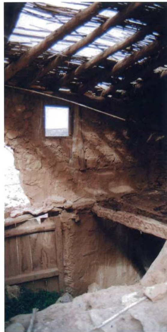
Sesga. Interior de una casa en estado precario
