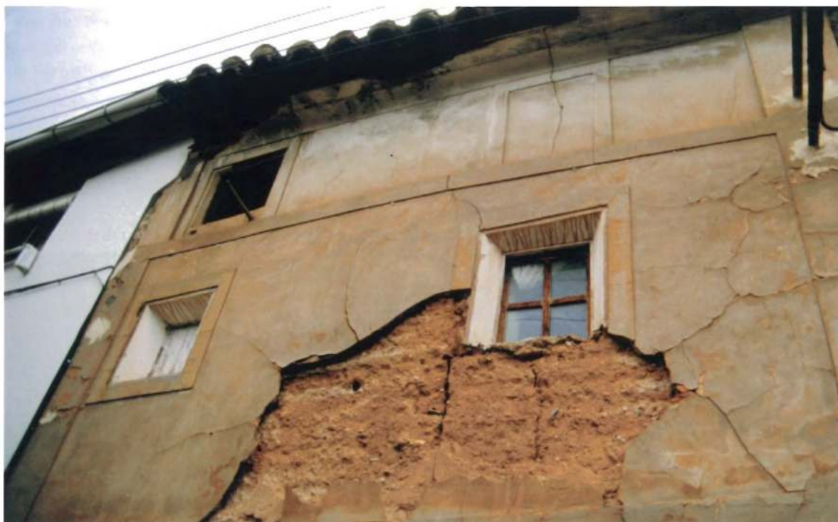
Ademuz. El revestimiento desprendido descubre la fábrica del cerramiento
