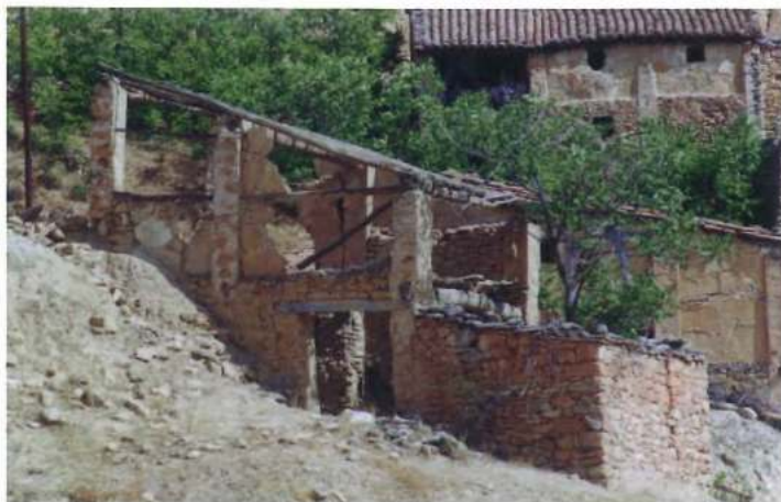
Val de la Sabina. Casa arruinada que desvela la estructura de la construcción
