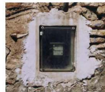
Torpe inserción de una caja de instalaciones en un muro tradicional
