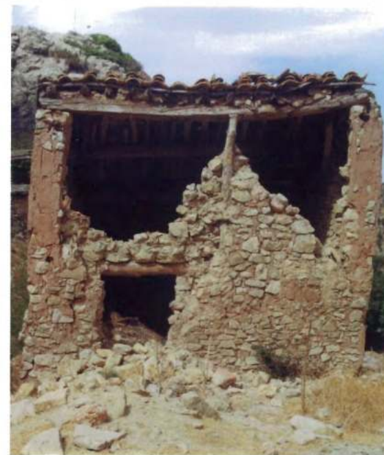
Sesga. Muro de mampostería arruinado
