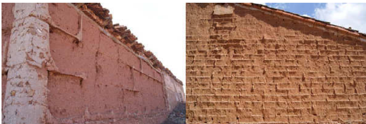
Figura 5. Tapia con brencas erosionada, pérdida de parte de las brencas y grieta por el apoyo de la viga de cubierta en Martín del Rio y muro de adobes con junta suplementada erosionados por lavado del paramento en Muniesa (Cuencas Mineras) Fuente: L. Villacampa
