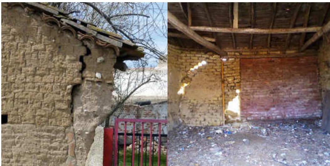
Figura 7. Mecanismos de fallo estructural en construcciones de adobe: 7a. Giro de una fachada por empuje de la cubierta. Santiago de la Puebla, Salamanca. Fuente: Javier Gómez. 7b. Fallo estructural por apertura de un hueco en Lagunilla de la Vega, Palencia. Fuente: Fernando Vegas y Camilla Mileto.
