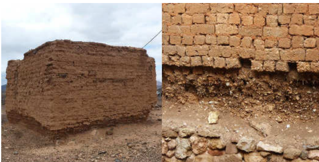
Figura 1. Pérdida de sección en el arranque de un muro de adobe por ascensión de humedad capilar: 1a. Muro de adobe carente de zócalo en Fuerteventura, Las Palmas. 1b. Muro de adobe con zócalo de mampostería en Poza de la Sal, Burgos. Fuente: Fernando Vegas y Camilla Mileto.
