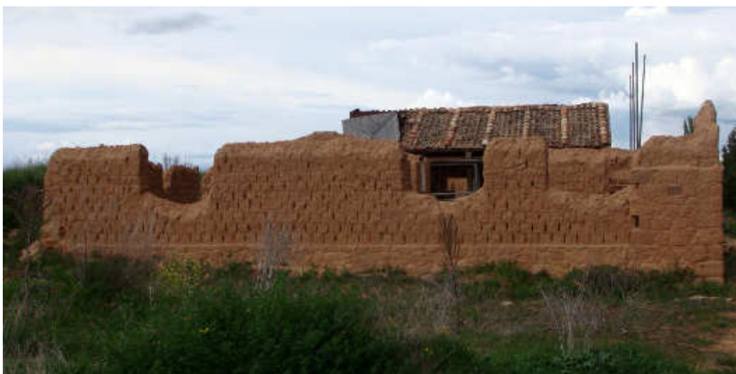
Figura 2. Lavado de la coronación de un muro de adobe en Navapalos, Soria. Fuente: Fernando Vegas y Camilla Mileto.
