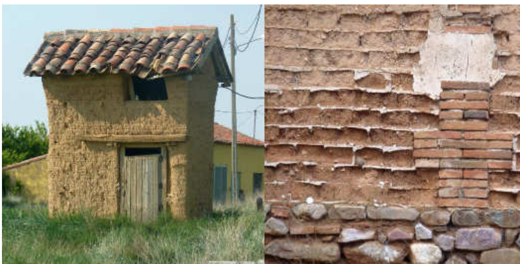
Figura 3. Erosión superficial de los muros de adobe: 3a. Edificio de adobe con erosión homogénea concentrada en las esquinas. Villada, Palencia. 3b. Erosión de un muro de adobe tomado con mortero de cal en Fuentes de Jiloca, Zaragoza. Fuente: Fernando Vegas y Camilla Mileto.
