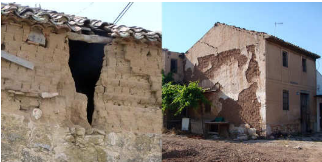
Figura 6. Lesiones derivadas de un inadecuado mantenimiento: 6a. Erosión de un muro de adobe debido la caída puntual de un alero en Muñana, Ávila. Fuente: Javier Gómez. 6b. Pérdida del revestimiento en una vivienda de adobe en Valencia. Fuente: Fernando Vegas y Camilla Mileto.
