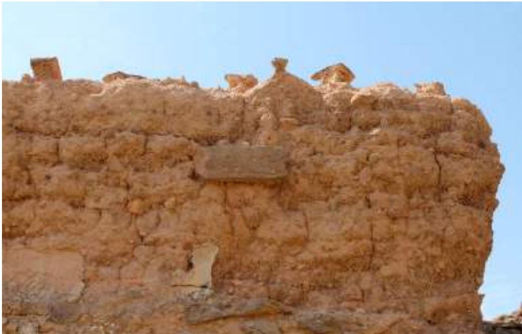
Figura 6. Detalle del descalce de un mampuesto en posición central en un muro de tapia careada con piedra (Campo Arriba, Alpuente)
