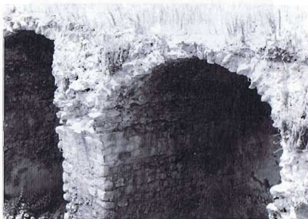
10. El abandono ha ocasionado el colapso de algunas bóvedas del conjunto.
