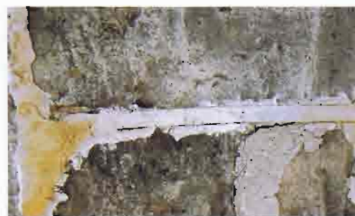
17. Restos de junta original
