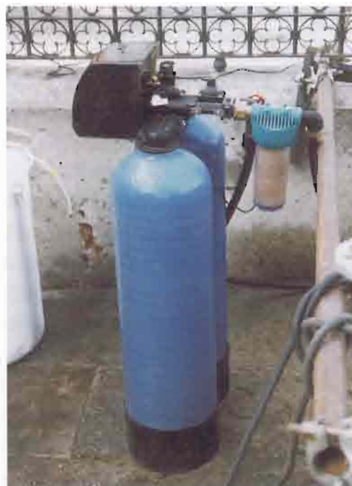
8. Descalcificador para el agua de la red
