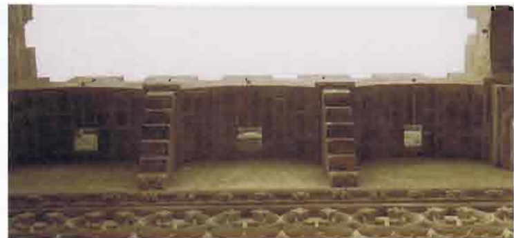
37. Los buzones matafuego con el vidrio de seguridad
