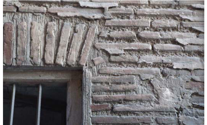
Le mortier montre clairement l'insertion de la fenêtre dans un mur préexistant.
