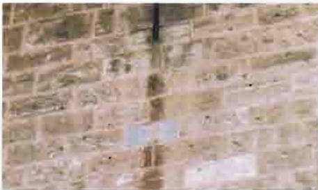
68. Mancha de oxidación
