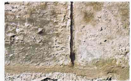
81. Pérdida de material
