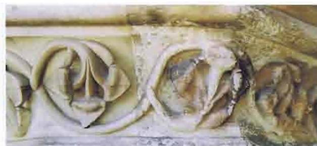
24. Encuentro entre la parte original y la rehecha de la moldura del apoyo
