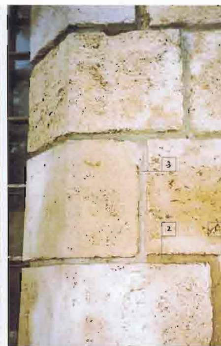
36. Detalle de la ventana donde se aprecia la superposición de tres tipos diferentes de mortero
