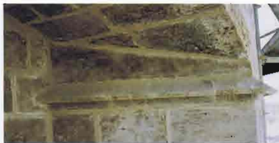
20. Detalle de un apoyo con la sustitución de algunos sillares y de la moldura que separa el apoyo de la bóveda del adarve
