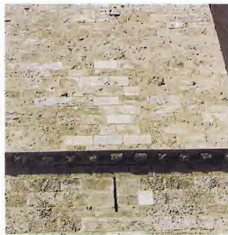
12. En la parte superior de la faja se percibe la zona del antiguo vano tapiado
