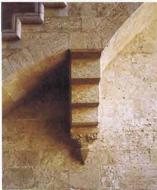
69. Apoyo reconstruido de la escalera de la nave izquierda del primer nivel
