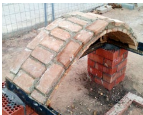
Figura 9. Bóveda tabicada de BTC con mortero de tierra construida en la Universitat Politècnica de Valencia.
